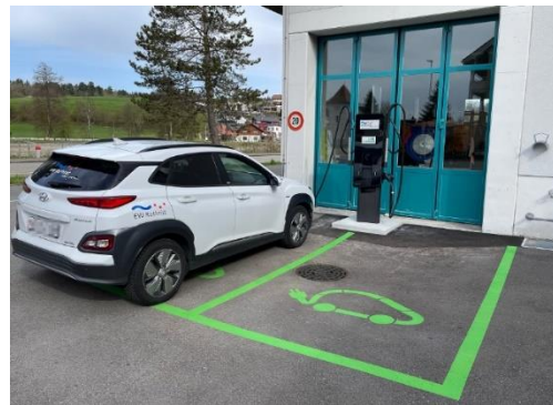
Bild: E-Ladestation beim Mehrzweckgebäude an der Gländstrasse
