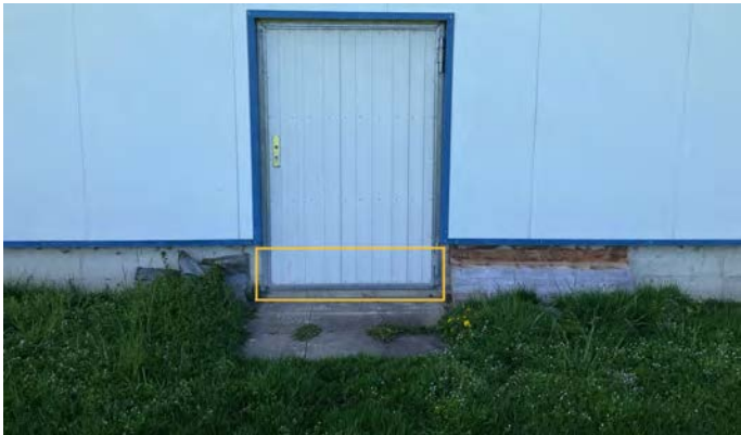
Abdichtung Nottüre der Rollhockeyhalle
